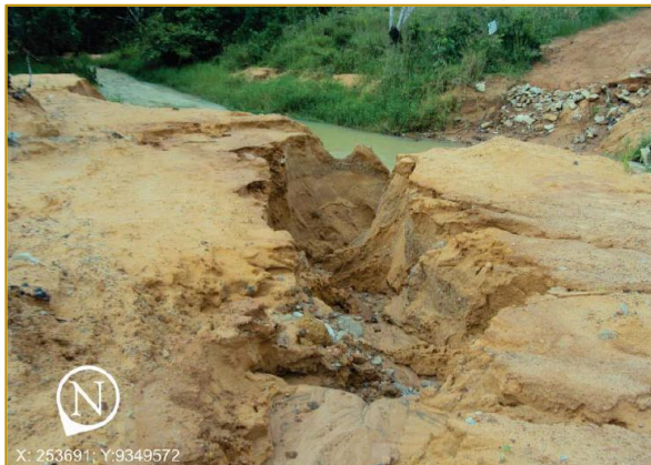
Figura 2: processo erosivo na margem esquerda do Rio Pitimbu (07/05/2011)
