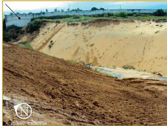
Figura 7: Formação dunar, a ser protegida com GEOCÉLULA, e ao fundo condomínio sobre a APP (20/05/2011)
