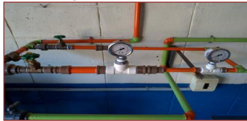
Figura 8- Tubo de Venturi
