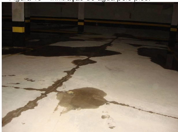
Figura 10 – Infiltração de água pelo piso.
