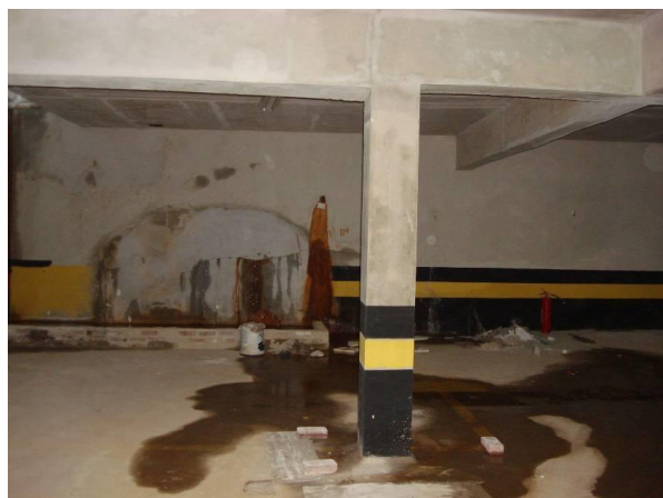
Figura 9 – Infiltração de água pela parede.
