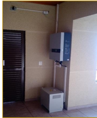
Figura 10: Visão geral da instalação do inversor
