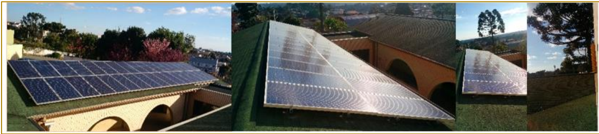
Figura 8: a) Arranjo físico dos Painéis do SFVCR, b) Estrutura de Fixação, c) Sombreamento Parcial
