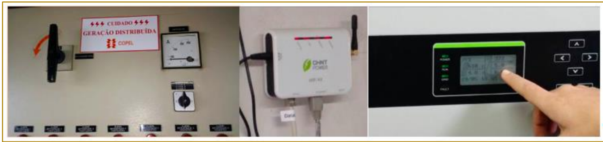
Figura 5: a) Distribuidor Geral, b) Data Logger e c) Parâmetros do Inversor
