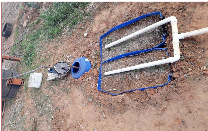
Figura 1 - Filtro instalado, já em uso
