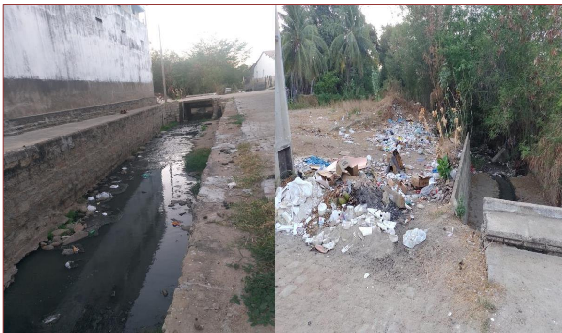
Figura 2: lançamentos de resíduos próximos e dentro do canal de drenagem
