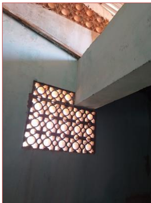
Figura 04 – Viga projetada fora dos padrões das normas técnicas brasileiras com apoio em cobogó
