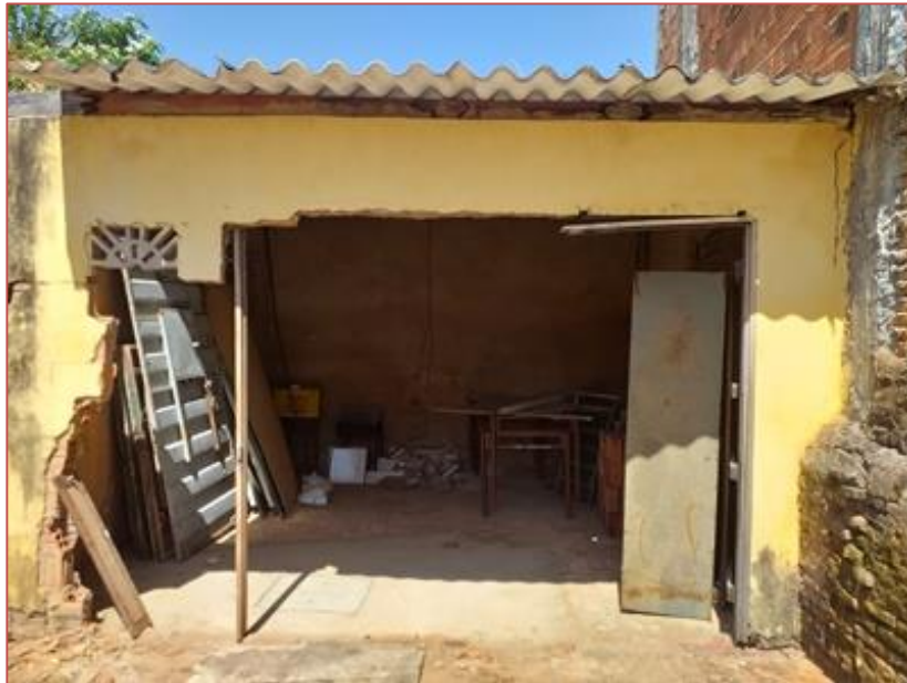
Figura 02 – Desabamento parcial da estrutura devido estado avançado de rachaduras em consequência da autoconstrução
