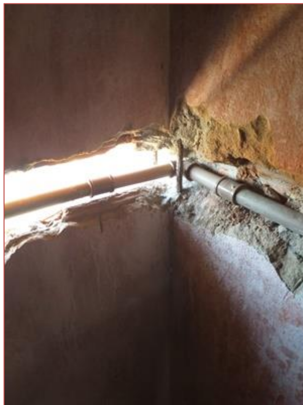
Figura 03 – Danificação de pilar para passagem de tubulação de água fria sem auxílio de profissional capacitado
